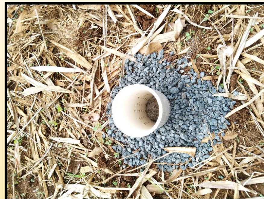
Pozo de observación
